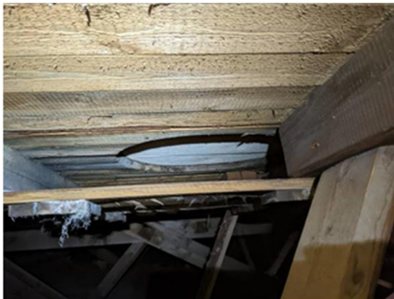
Vanha läpivienti laitettu umpeen, vuotoja tapahtunut läpiviennistä
