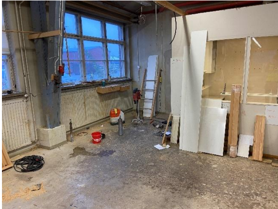
Värjäytymää lattiassa, mahdollisesti maalia tai lakkaa
