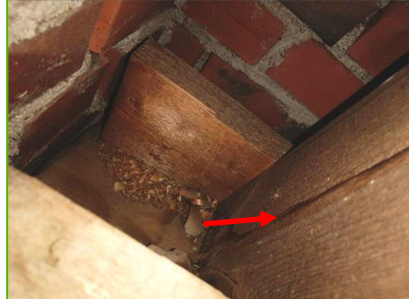
Kehäpilarin liittymässä eristettä ohuemmin, pilarissa halkeama
