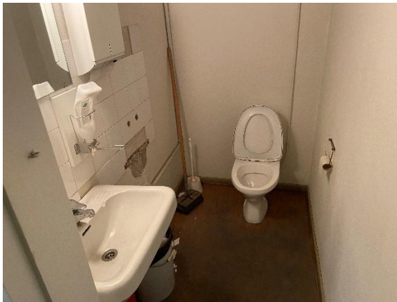
WC:n vanha muovimatto
