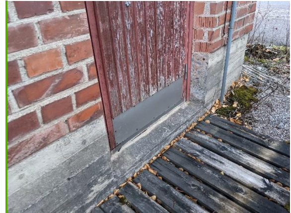
Länsisivun oven maalipinnoite hilseillyt, paneeli halkeilee
