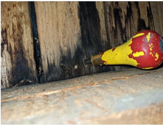
Alusruoteet lahonneet läpiviennin ympäriltä
