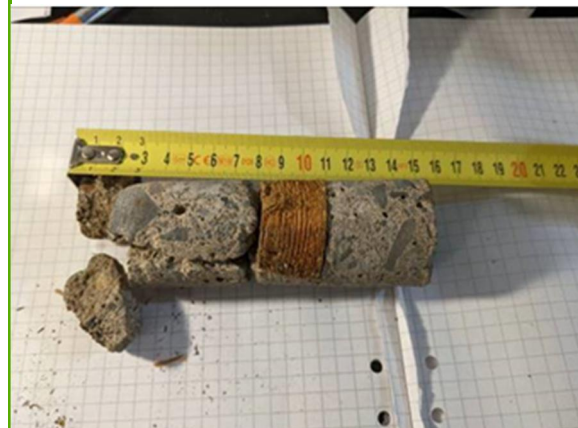
Näytteessä 01 muottilaudan pala, betoni halkeilu ulkopinnasta
