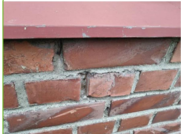
Pohjoispäädystä saumaa seuraava halkeama
