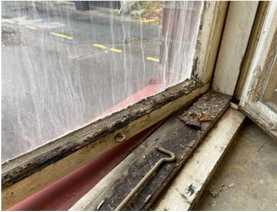
Puiteväli kastunut ja likaantunut voimakkaasti, ikkunan puitteet aukeavat sisälle ja ulos
