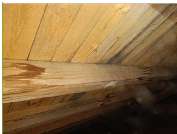
Vesivuotojälkiä ja tummentumia puuosissa
