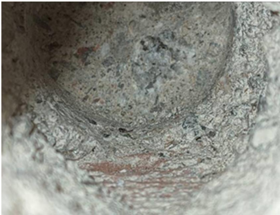
Julkisivumuurauksen ja aukkopalkin välissä ei eristettä
