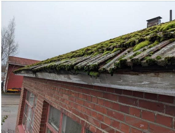
Räystäällä painumia ja lahovaurioita
