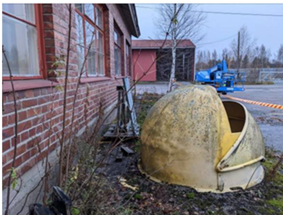
Kasvillisuus rakennuksessa kiinni länsisivulla, sammalta kasvaa asfaltissa
