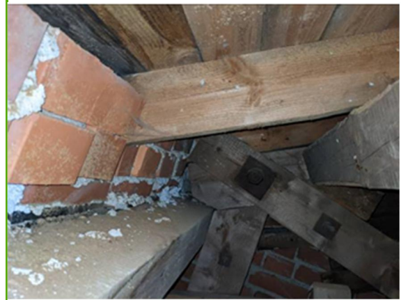
Räystäällä vesivuotojälkiä, huopa tiilen ja palkin välissä
