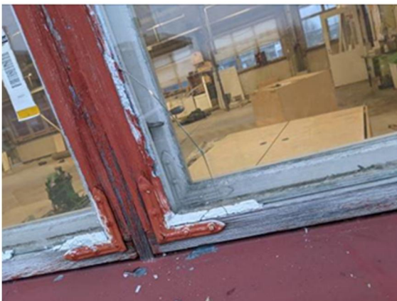
Länsisivulla lasituskittauksia tippunut, puuosat halkeilleet ja harmaantuneet, rikkiäinen lasi
